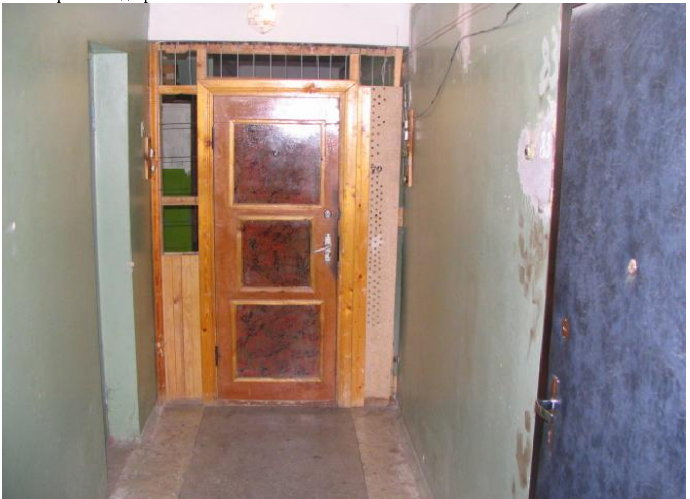
Самовольное сооружение непроектных перегородок в коридорах жилого дома снижает эффективность дымоудаления из коридора здания, осложняет эвакуацию людей и материальных ценностей.
