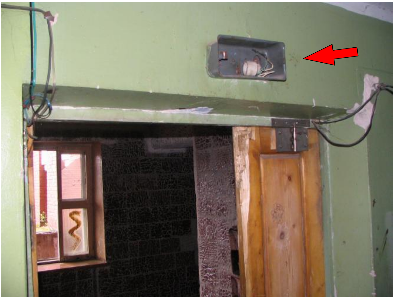
Неисправный световой указатель «Выход» из коридора жилого дома. Отсутствует устройство для самозакрывания двери.
