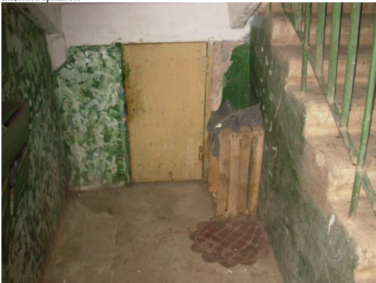
Сооружение непроектных кладовых под маршем лестничной клетки в жилых домах запрещается.
