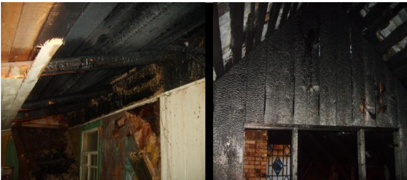
Пожар в одноэтажном кирпичном жилом доме по адресу г.п. Боровуха-1 ул. Озерная д.44. Причина пожара нарушение правил эксплуатации печного отопления.
