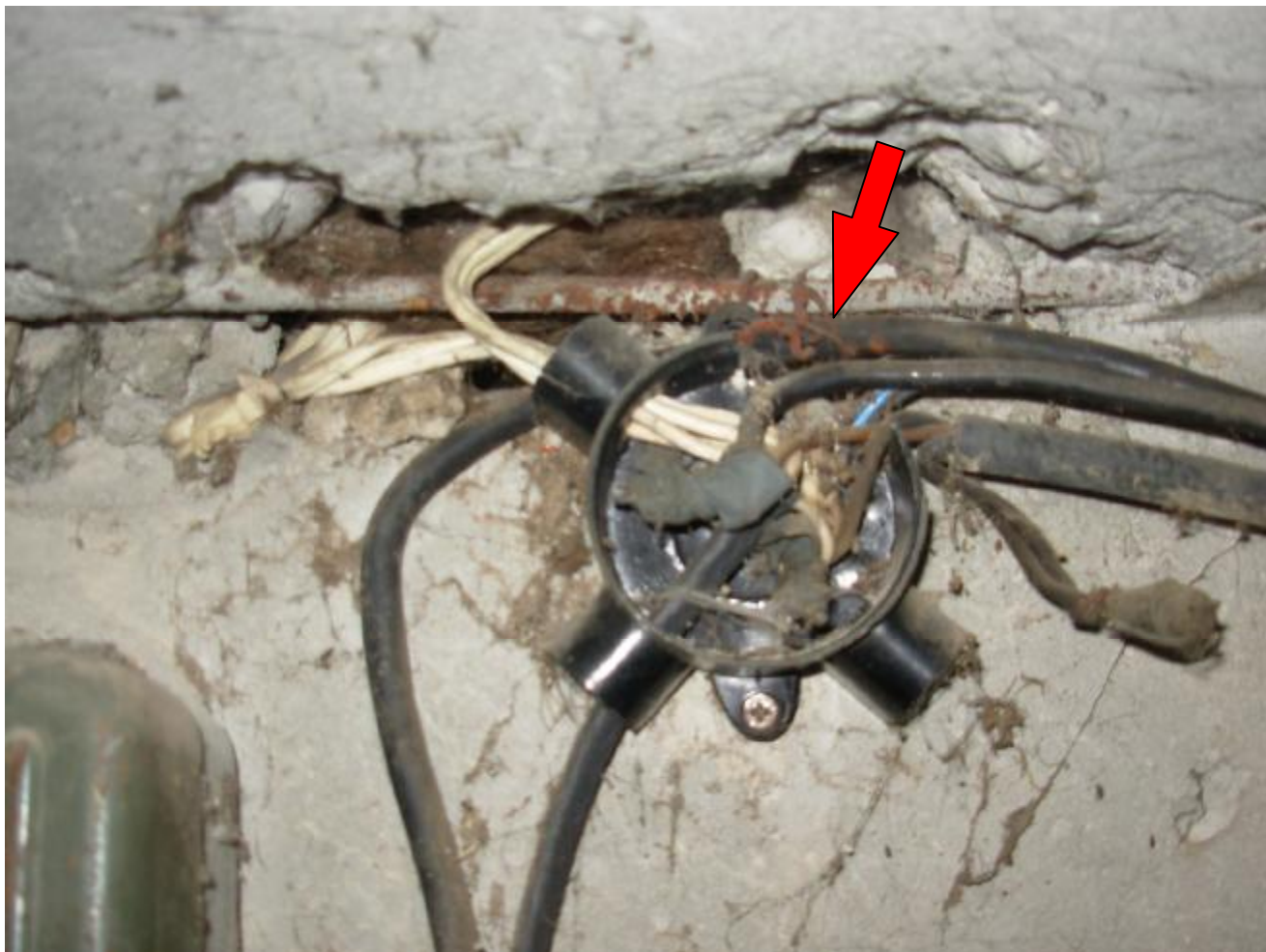
Соединение электрических проводов при помощи скрутки, разветвительная коробка не закрыта защитной крышкой.
