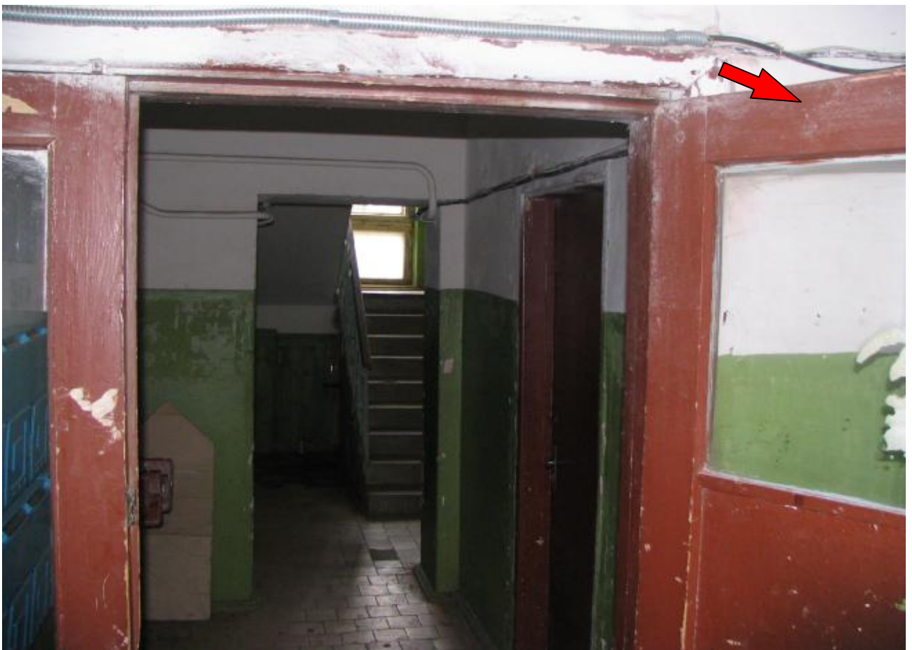
Снятие устройств для самозакрывания дверей, отделяющих лестничную клетку от помещений иного назначения запрещается.
